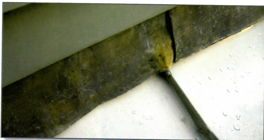
Statt Silikon-Dichtung? Dieser Übergang von der Gaubenverkleidung zum Falzdach konnte mit Walzblei-Streifen wirklich elegant gestaltet werden.
